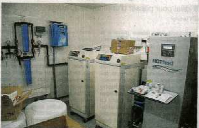
L'établissement est doté d'un équipement de traitement de l'eau très performant, pour disposer d'une eau de bonne qualité.
